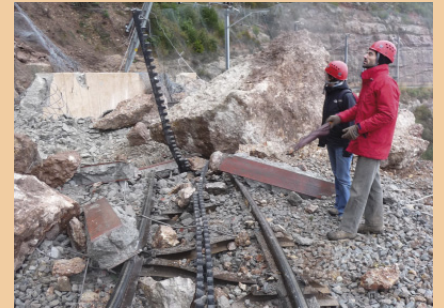
Efectes d'un desprendiment sobre la via del cremallera de Montserrat
