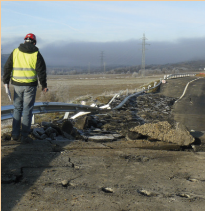
Lliscament que va provocar la destrucció de la carretera C-1412b, al seu pas per Isona i Conca Dellà
